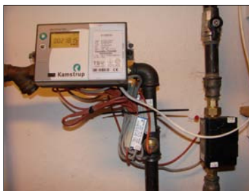
Ny målerinstallation anno 2008
