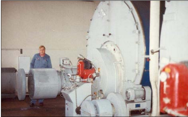
Varmemester Vagn B. Petersen foran et par oliefyrede kedler på værket
