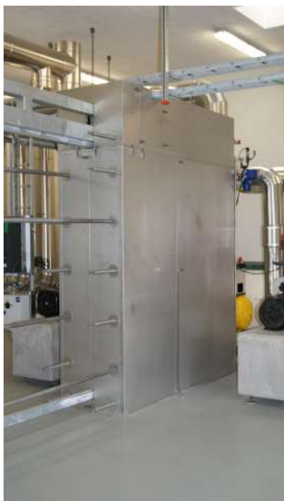
Interiørbillede fra teknikbygningen, der viser den pladevarmeveksler der adskiller solpanelernes vand fra fjernvarmevandet.
